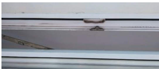
Rys. 16. Górna część ościeżnicy okna z częściowo wyciętą uszczelką
