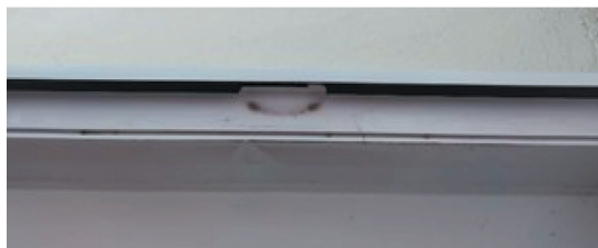
Rys. 14. Górna część ościeżnicy drzwi balkonowych z częściowo wyciętą uszczelką
