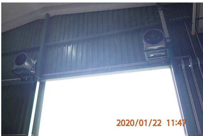
Rys. 10. Wentylatory w obiekcie nr 8a w KSOP (źródło własne).
