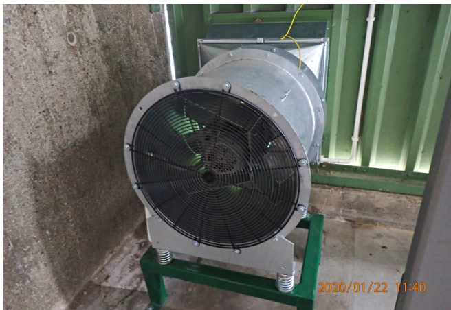
Rys. 9. Wentylator w obiekcie nr 8a w KSOP (źródło własne).
