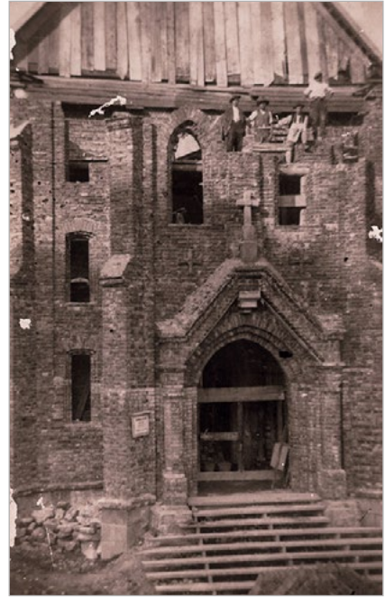
Prace przy głównym wejściu do kościoła w Korbielowie, koniec lat trzydziestych XX wieku
