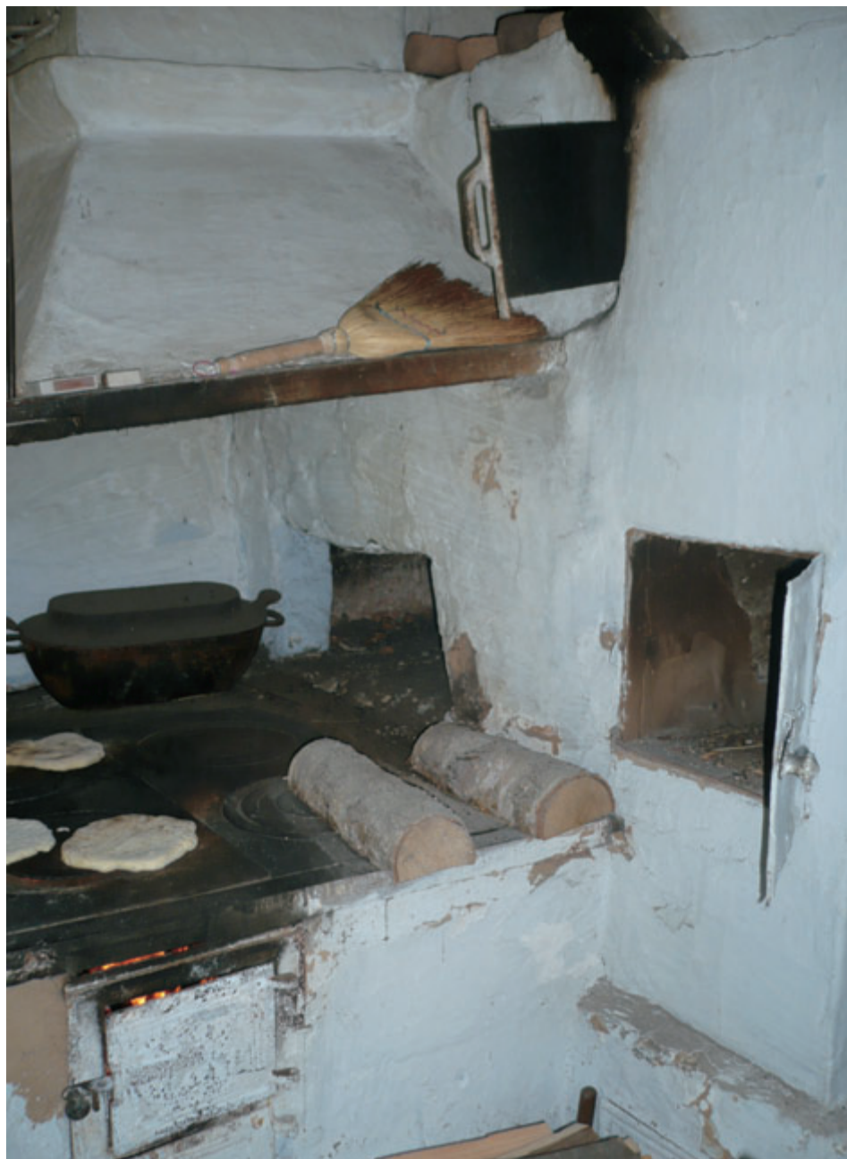
Ilustracja 29. Pomieszczenie wewnątrz pieca kuchennego, w którym przechowuje się gorącą potrawę
