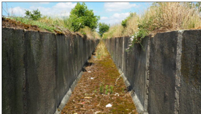
Fot. 7. Główny kolektor ścieków. Fot. Krzysztof Kolenda
