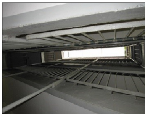
Fot. 3. Klatka schodowa, gdzie przewidziano rurociągi i kanał nawiewny (opracowanie Stefan Reszewski)
