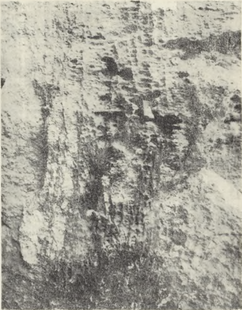
Ryc. 29. Korodowana polewa naciekowa na ścianie rozwartej szczeliny (fot. A. Henkiel) Corroded dripstone formation cover is on the face of a gaping joint
