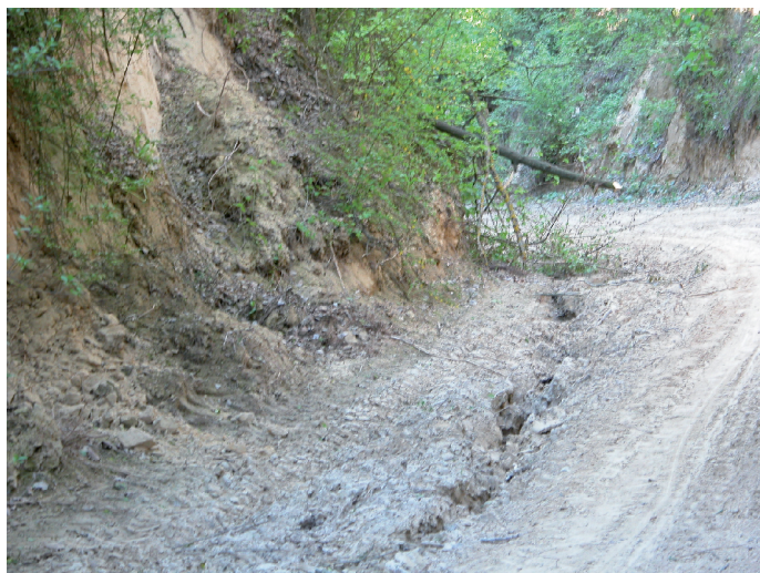
Fot. 1. Bruzda erozyjna rozcinająca dno wąwozu drogowego w rejonie miejscowości Dobre Erosion rill dissecting the bottom of the road gully near Dobre
