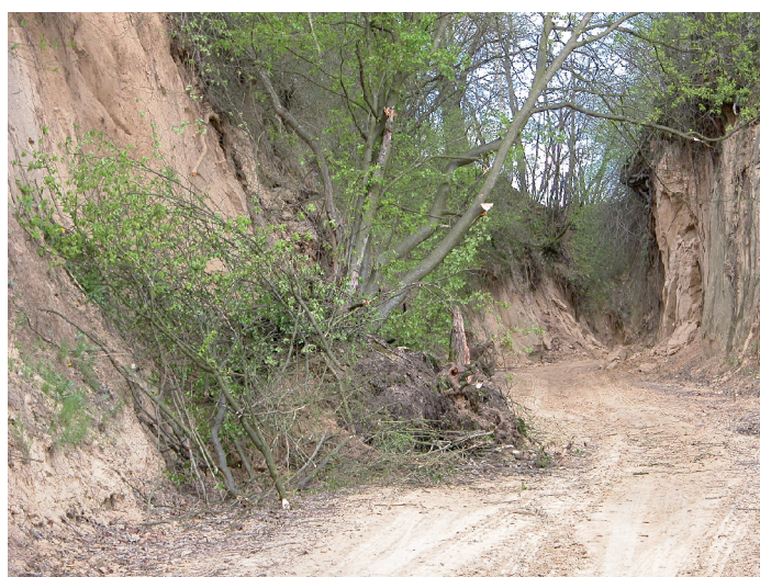
Fot. 2. Osuwiska na zboczu wąwozu drogowego w rejonie Rogowa Landslides on the slope of the road gully near Rogów
