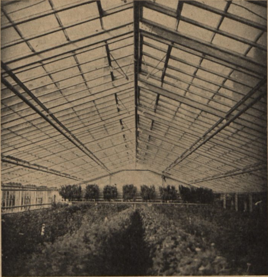
Fragment wnętrza: nowoczesna wolnonośna, szeroko-przestrzenna 12,5 m szerokości hala do hodowli róż lub masowej produkcji nowalii. System f-my „Budowa Cieplarni” w Warszawie
